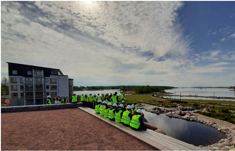
Kuva 6. Yhdessä Rakennusteollisuuden kanssa toteutettu rakennustyömaapäivä oli menestys myös säiden suhteen. YIT:n vastaava mestari Merja Tihula esittelee koululaisille Haminan Tervasaaren nousutta kerrostaloa. (kuva: Paavo Kriktilä)
